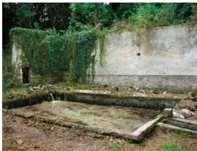
le lavoir de Montpichet avant travaux
